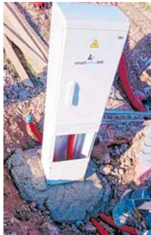
Ulični ormarić sustava koji će superbrzi internet dovesti do tisuća korisnika
